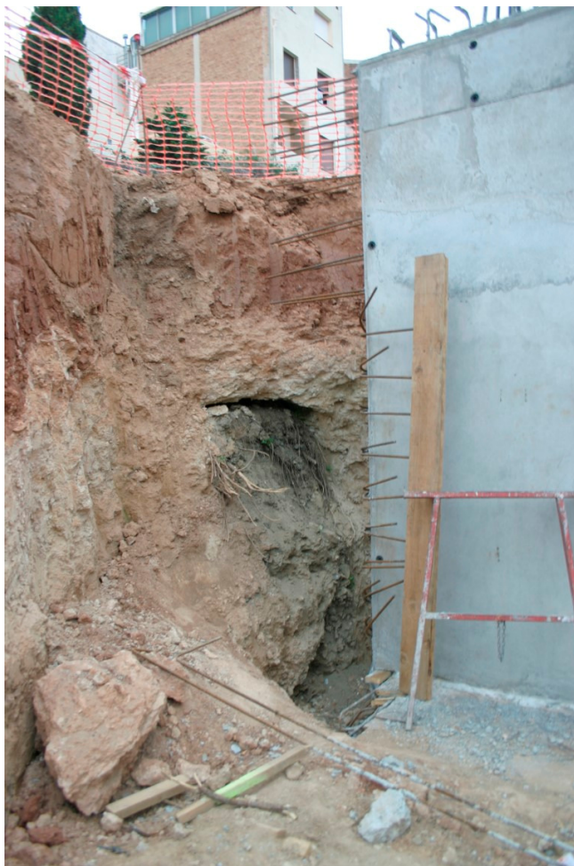
Vista de la secció de galeria localitzada en el decurs de l'obra, al moment d'iniciar la intervenció.
